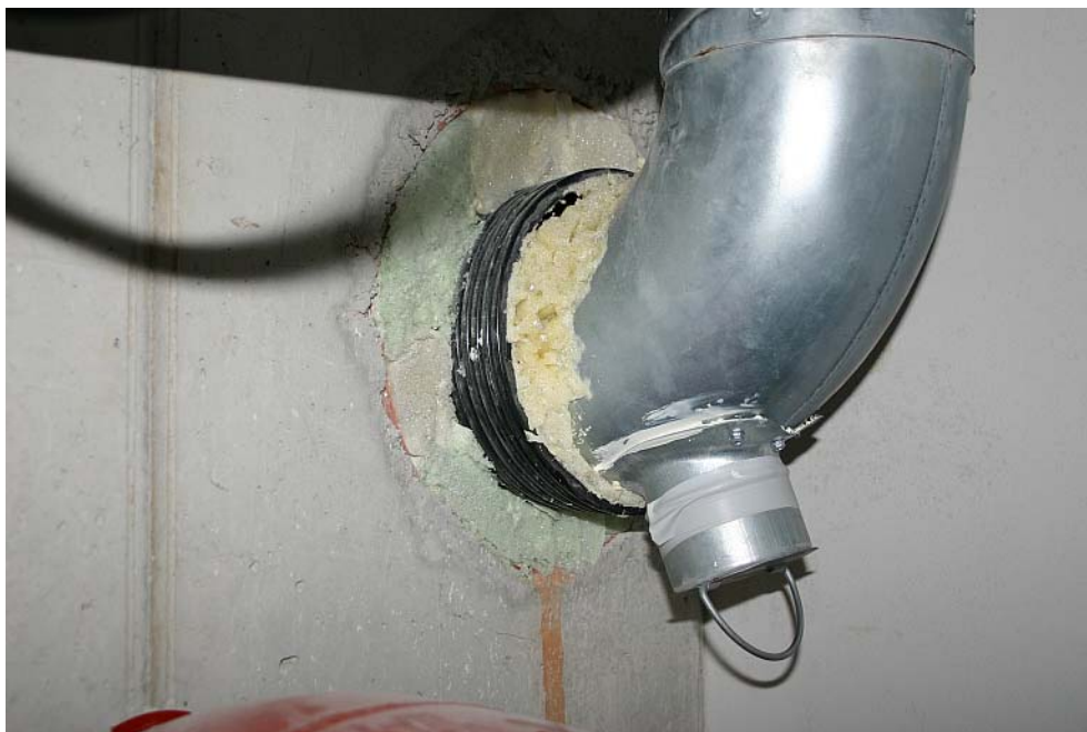
Abbildung 14: Nicht fachgerechte Ausführung des Anschlusses des gerippten Rohres eines LEWT an die Verrohrung zum Lüftungsgerät im Keller eines Einfamilienhauses (Tappler 2005)
