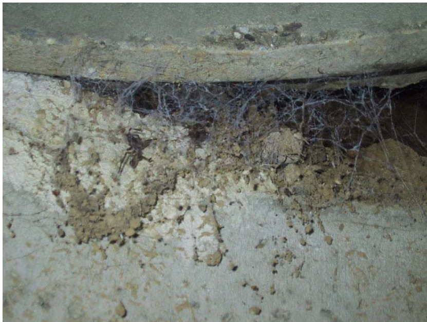
Abbildung 11: Unsachgemäße Ausführung der Betonrohre in einem LEWT – sekundäre Bildung von organischen Verunreinigungen (Spinnweben) (Twrdik 2005)
