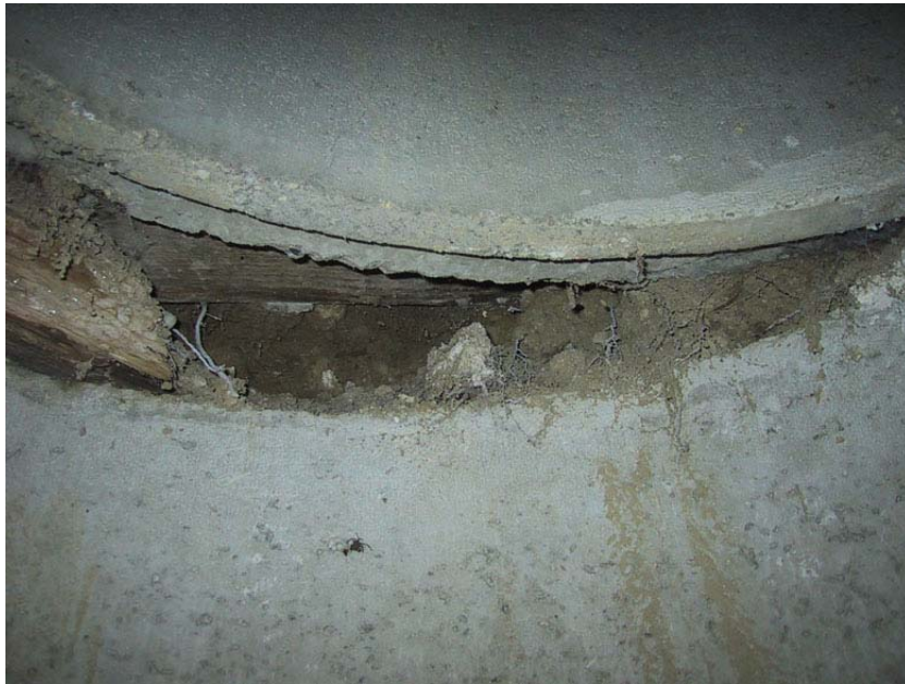
Abbildung 10: Unsachgemäße Ausführung der Betonrohre in einem LEWT – Eintritt von Bodenmaterial (Twrdik 2005)
